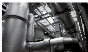
プラント配管
